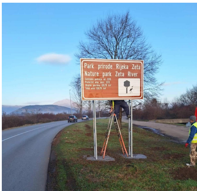
Foto 3: Signalizacija na Marezi
